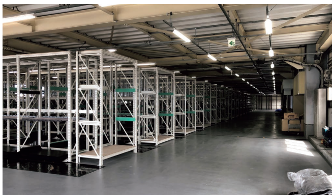
LED照明にすることで照明からの熱を無くし空調効率化を図る
